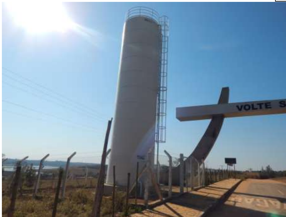
Foto 44 – Reservatório Apoiado II – Distrito Pontalete.
