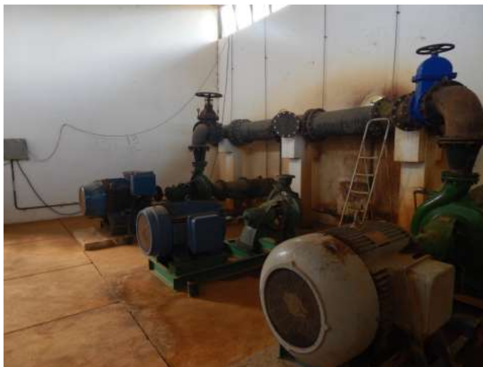
Foto 04 – Conjunto moto bomba EAB 4 – Sete Cachoeiras.
