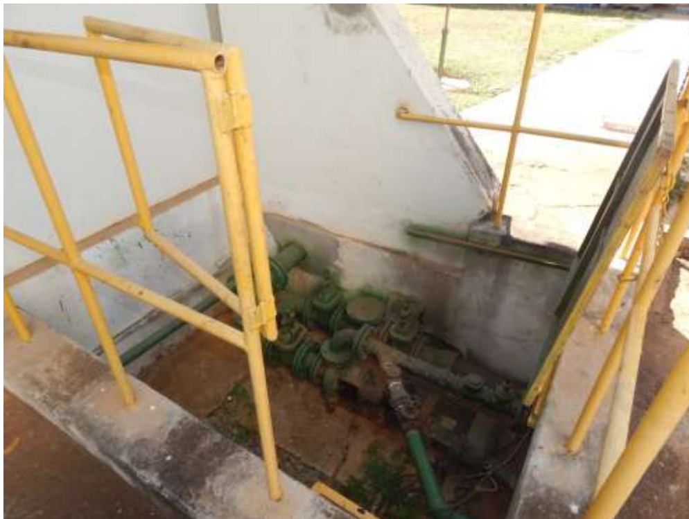
Foto 28 – Conjunto moto bomba de 10 cv – ETA I.
