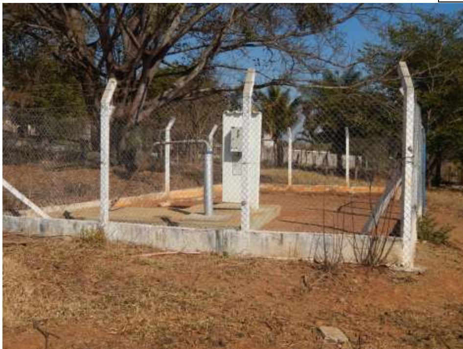
Foto 42 – Poço 3 – Distrito Pontalete.
