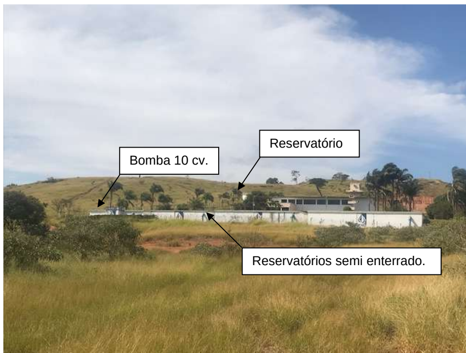
Foto 06 – ETA II – Reservatório semi enterrado, apoiado e bomba 10 cv.
