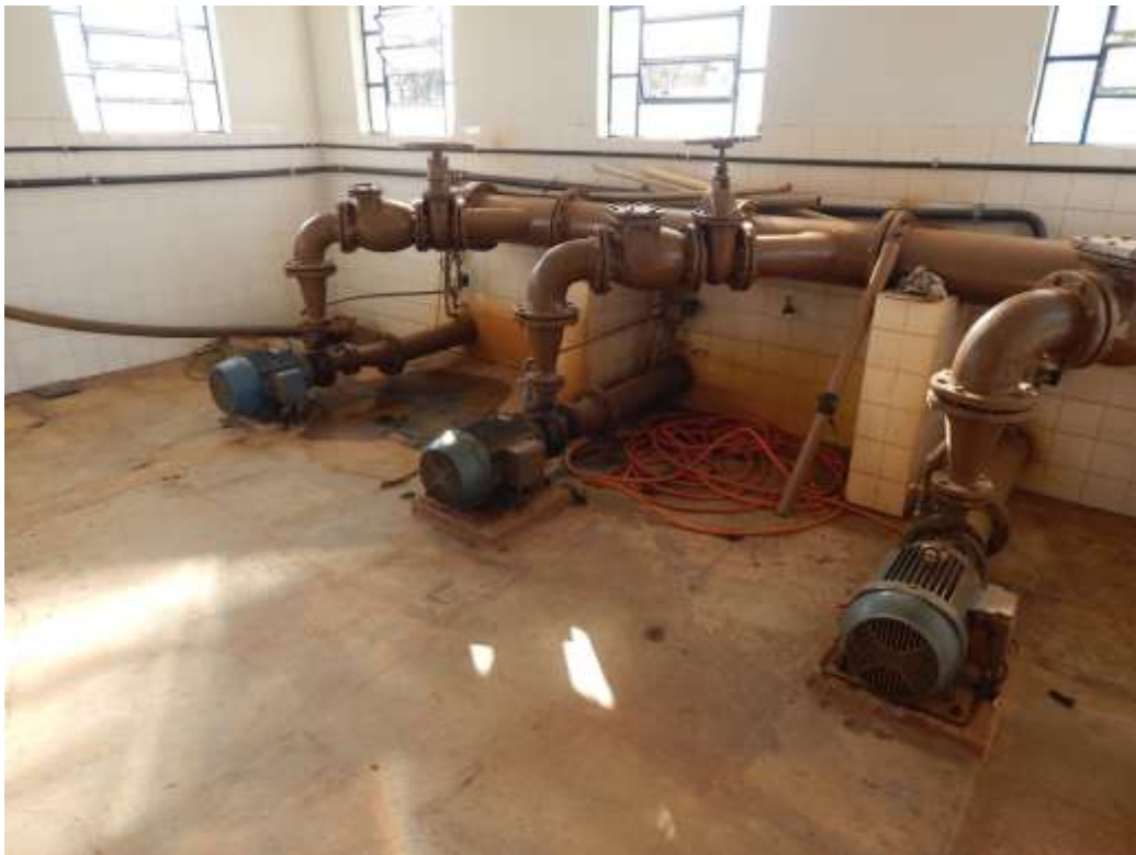
Foto 22 – Conjunto moto bomba EAB 1 – Quatis/Formiga.
