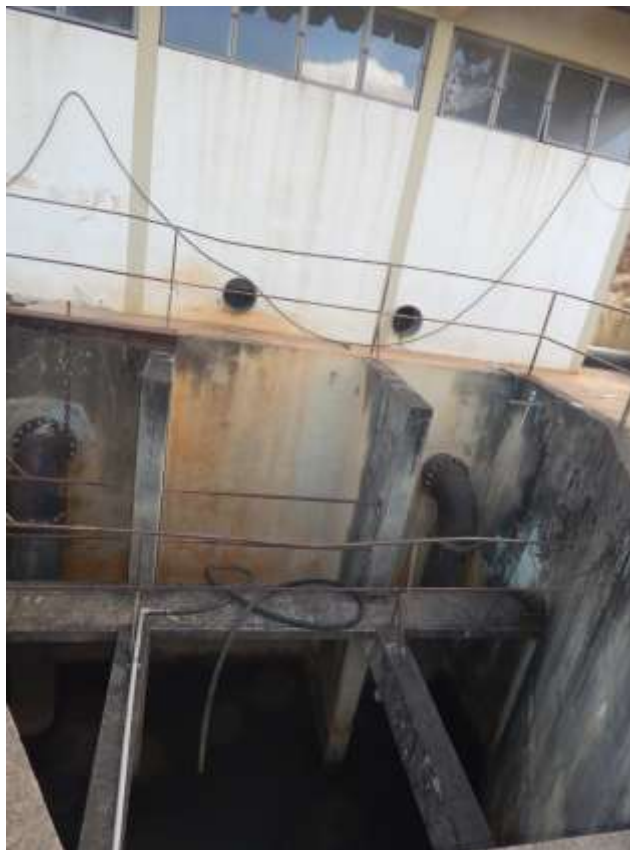
Foto 03 – Poço de sucção EAB 3 – Sete Cachoeiras.
