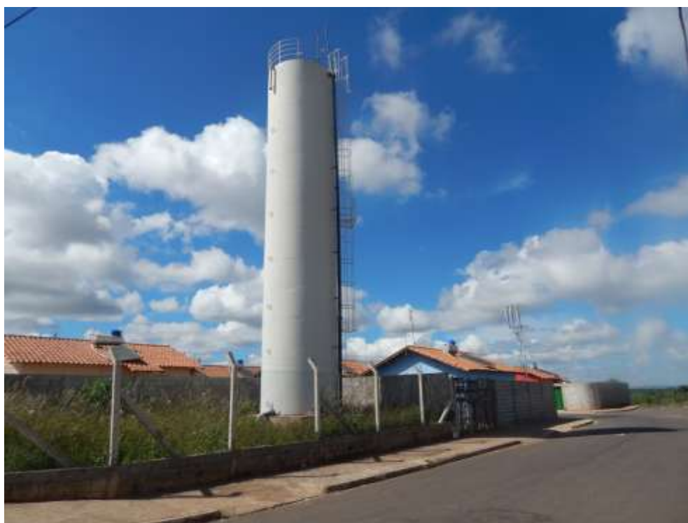
Foto 12 – Reservatório apoiado – Jardim das Esmeraldas.
