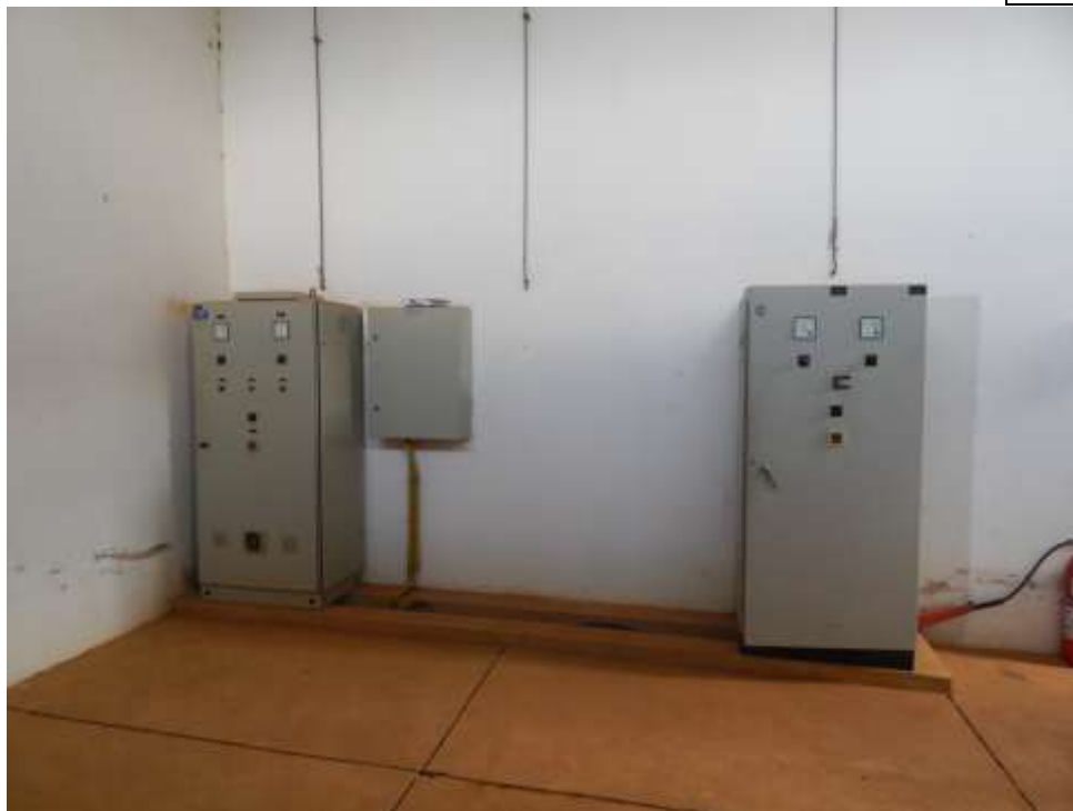
Foto 05 – Painel de comando (partida direta e soft start) EAB 4 – Sete Cachoeiras.
