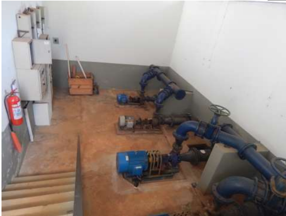
Foto 27 – Conjunto moto bomba 2 de 50 cv e 2 de 10 cv – ETA I.
