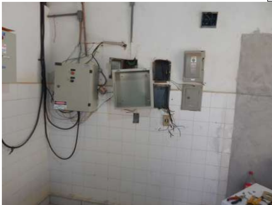
Foto 40 – Quadros de Comada EAT/Poços 1, 2 e 3 – Distrito Pontalete.
